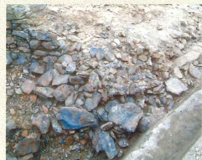
石出し 1 下流側先端部の崩落状況
