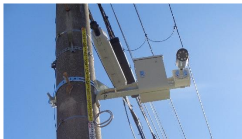
市内の電柱に設置された防犯カメラ
