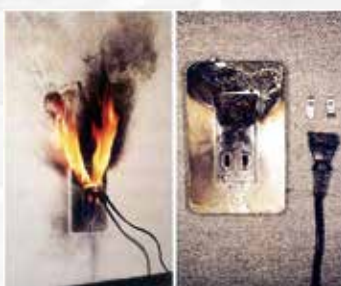
トラッキング現象
