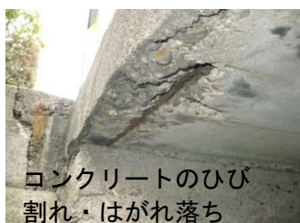
橋梁の損傷例
