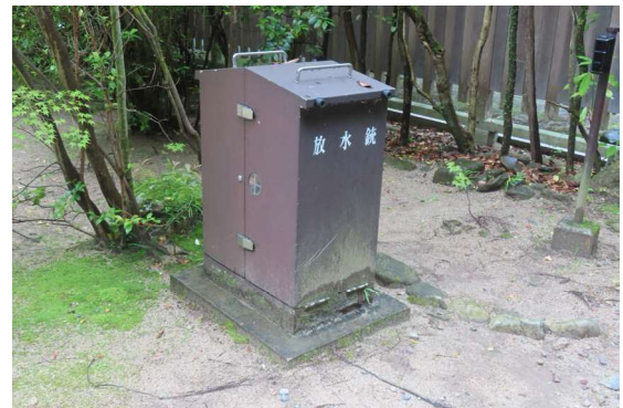
写真 5 - 62 (⑫) 放水銃格納庫
