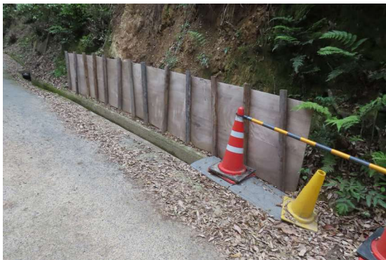
写真 5－8 (⑤) 市道宇治 6 号線沿い 土砂崩れ応急処置
