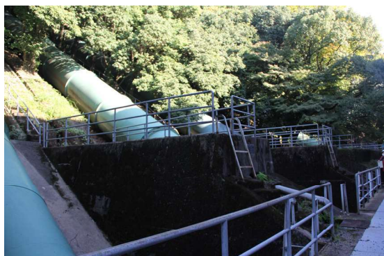
写真 5 - 127 (③) 水圧鉄管と周辺の植栽
