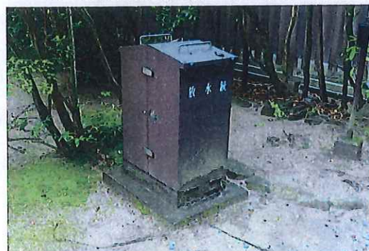
⑫ 放水銃格納庫
