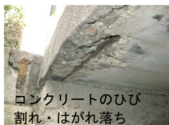
橋梁の損傷例
