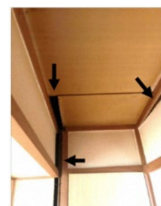
天井・壁の亀裂
