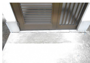
玄関踊り場の亀裂
