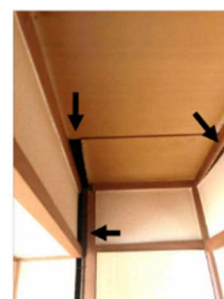
天井・壁の亀裂
