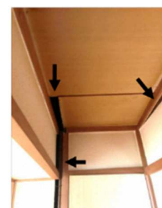
天井・壁の亀裂
