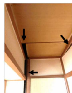
天井・壁の亀裂
