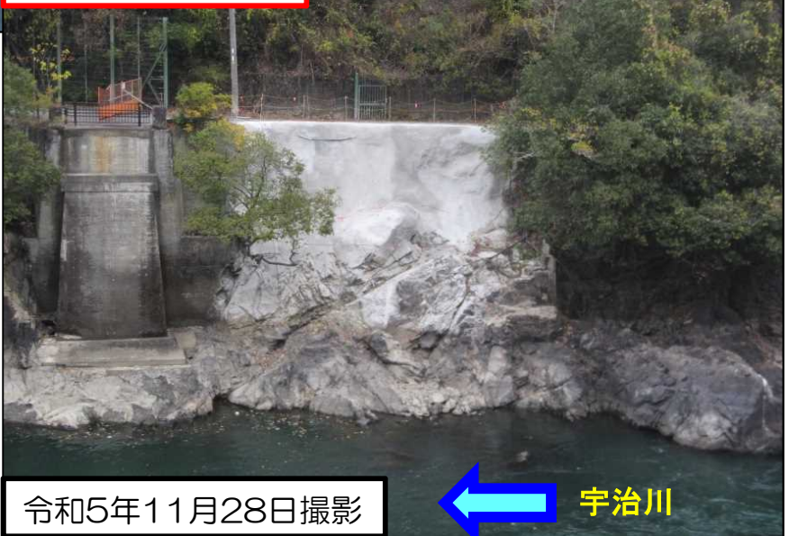
①道路法面崩落箇所
