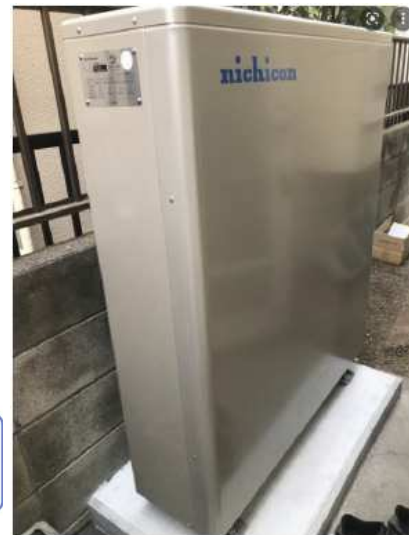
リチウムイオン蓄電池設備
