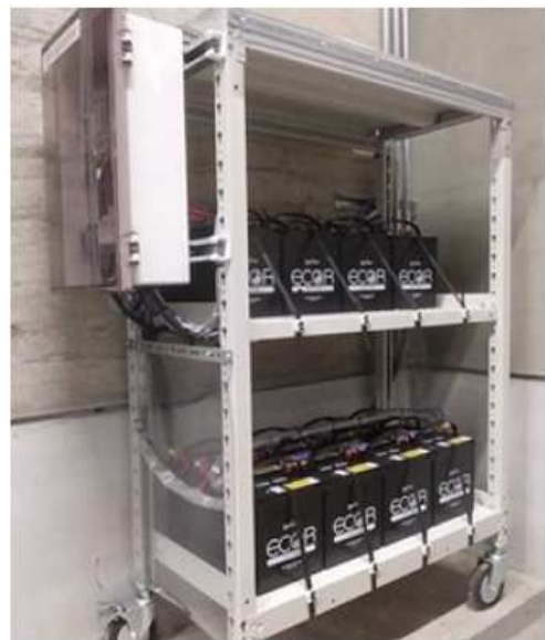
鉛蓄電池設備
