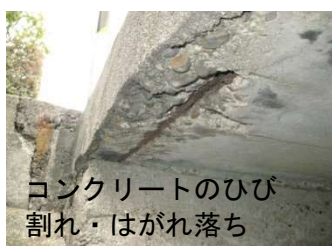
橋梁の損傷例
