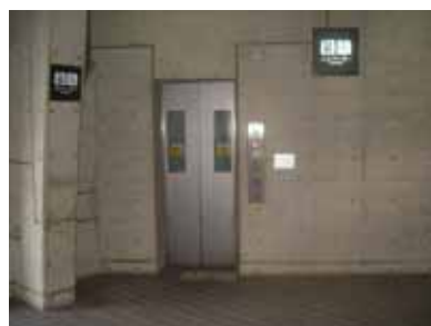
エレベーター
