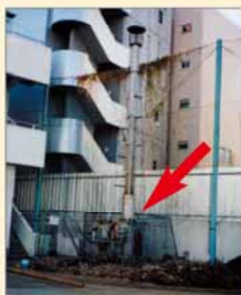
廃棄物焼却炉
