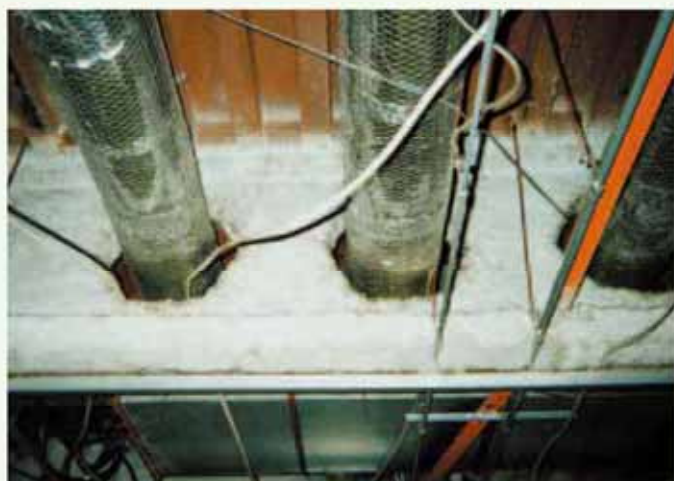
耐火被覆用吹付け石綿・石綿含有吹付けロックウール（S造の柱・梁等）
