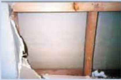
砒素・カドミ含有石膏ボード
