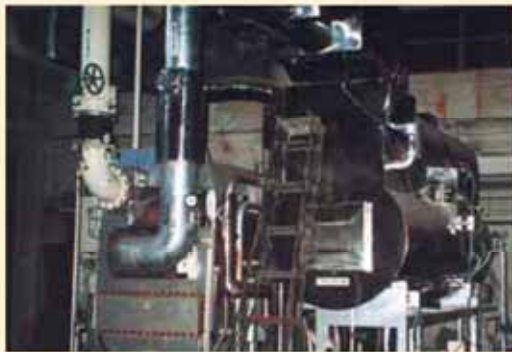
吸収式冷凍機
