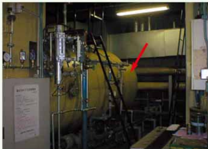
石綿含有保温材（ボイラ外周部）
