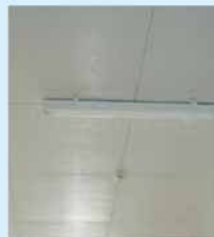
石綿含有けい酸カルシウム板 石綿スレート（天井）
