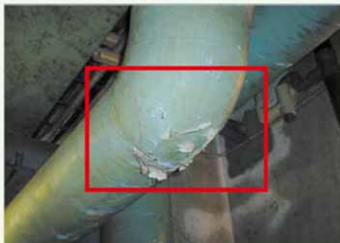
石綿含有保温材（配管曲がり部）
