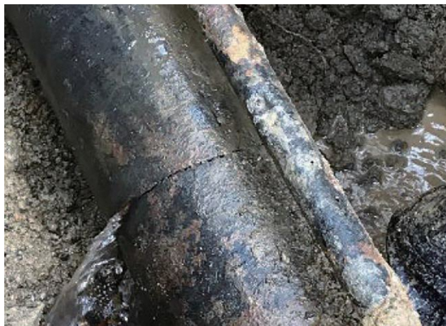
鋳鉄管の漏水
