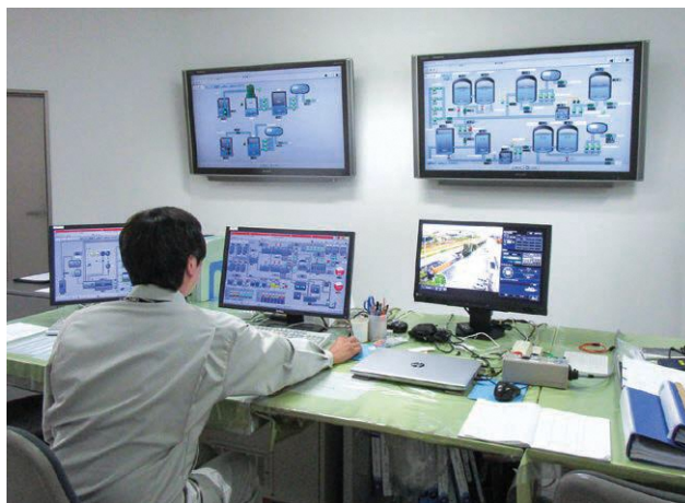
宇治浄水場中央監視室
