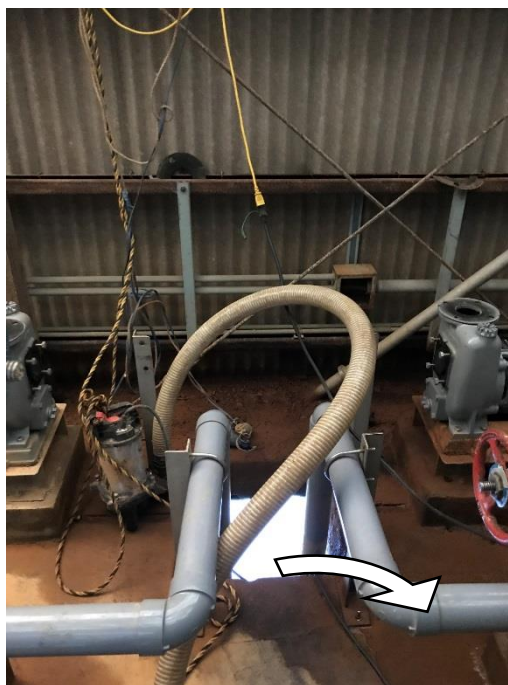
※ 4 ポンプ室内 ポンプ吸い上げ口
