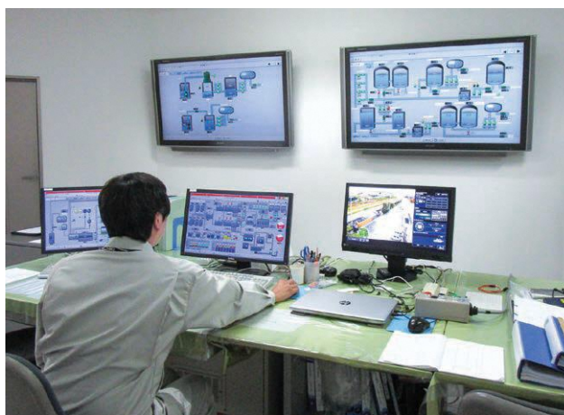
宇治浄水場中央監視室
