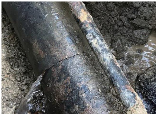
鋳鉄管の漏水
