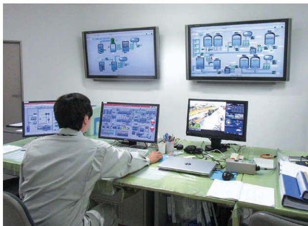
宇治浄水場中央監視室
