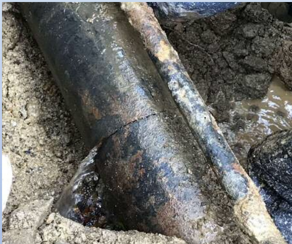
鑄鉄管の漏水
