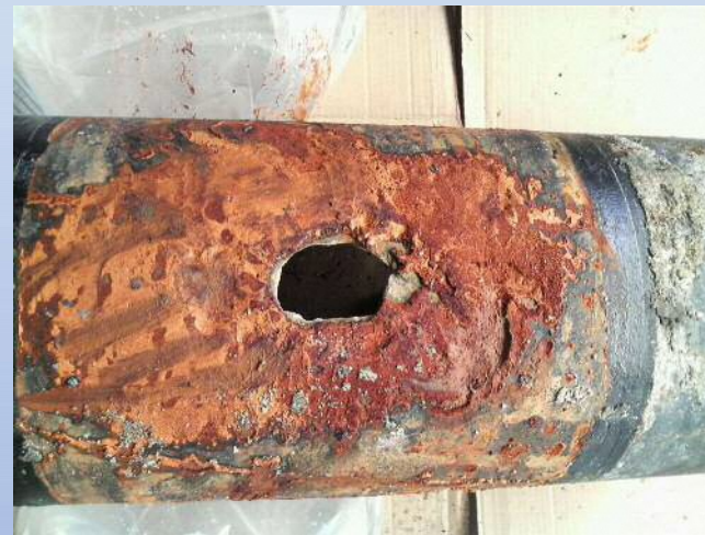
腐食し穴が開いた鑄鉄管
