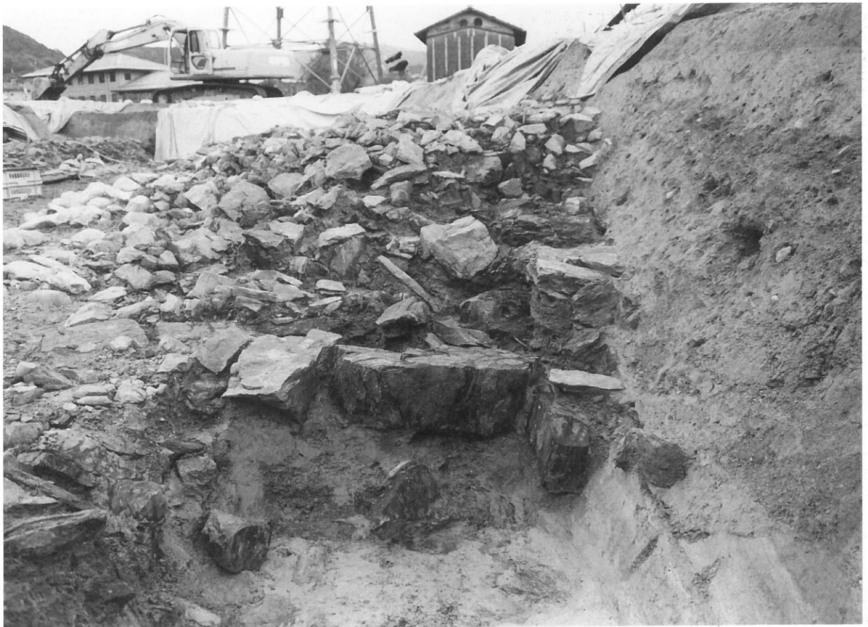
2. 護岸遺構 SX01 石出し 2 下流側崩落状況 (北から)
