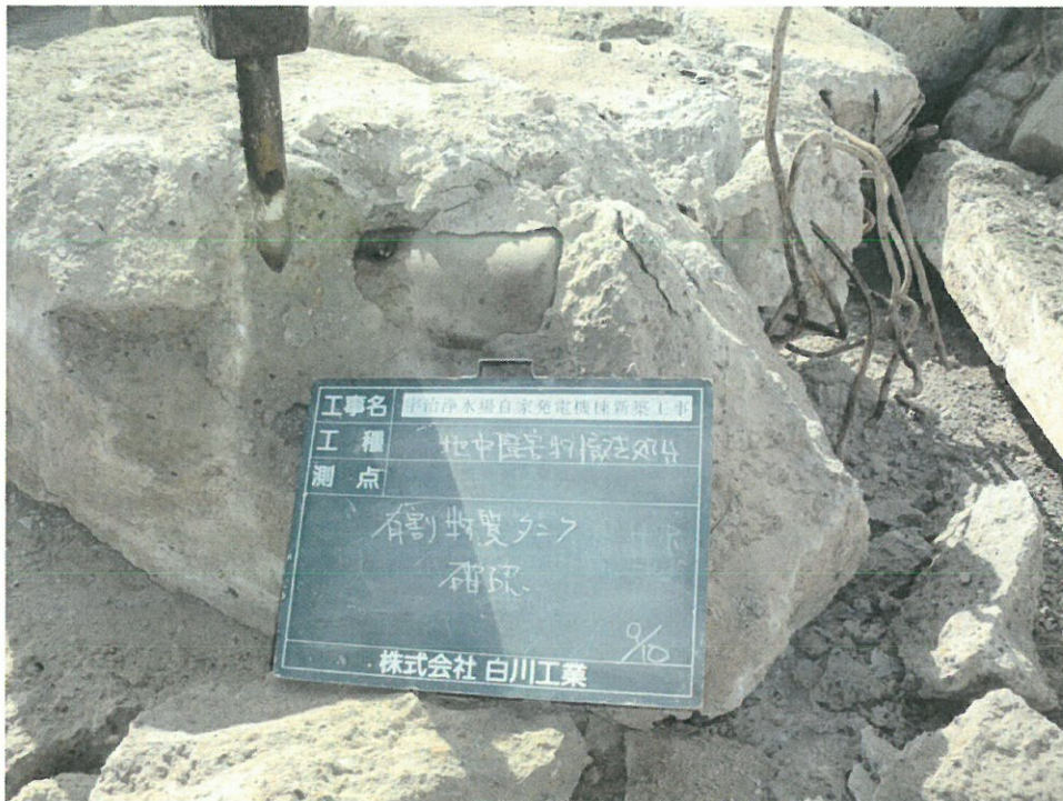
③ 9月10日 地中障害物破砕 コンクリート塊内のボンベ破損状況
