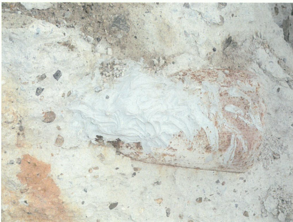
④ 9月10日 地中障害物破砕 コンクリート塊内のボンベ損傷処理 パテ処理の上変成シリコン打設
