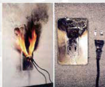
トラッキング現象
